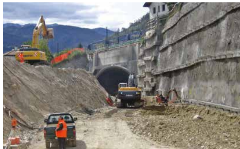
16. Gli scavi ravvicinati ai fabbricati di edilizia civile eseguiti in terreni alluvionali che hanno richiesto continua verifica del progetto
