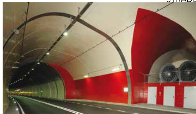
18. La piazzola di sosta con la camera di ventilazione e i due ventilatori della galleria Sud
