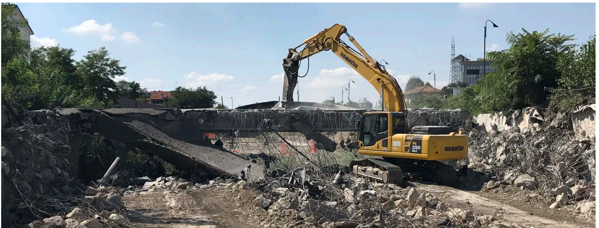
Sopra, la demolizione di una galleria che verrà poi ricostruita. In basso, i macchinari attivi nell'area: quello per evitare la risalita dell'acqua e quello per posizionare i diaframmi
